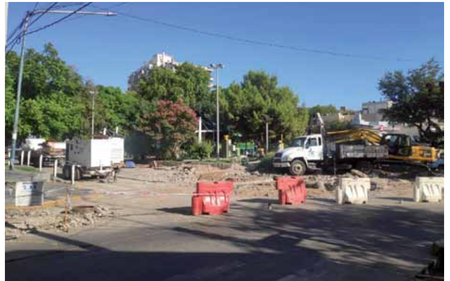
Es una obra complicada porque los operarios trabajan a cinco metros de profundidad.
